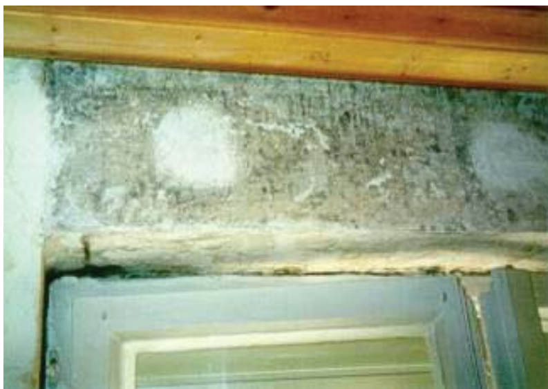
Dold mögeltillväxt i kalla klimat (bakom invändig isolering)
